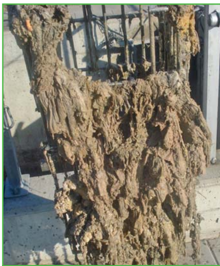
Zanesený sběrný koš při nátoku do ČOV
