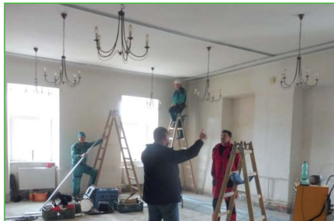
instalace, elektro, topení
