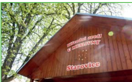
poškození znaku na přístřešku
